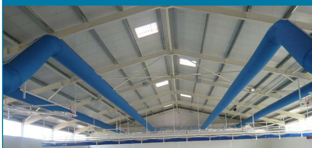
Lange, cirkelvormige luchtkanalen
